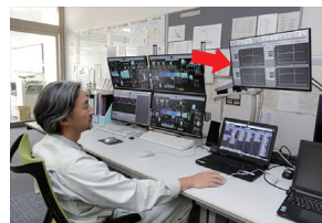
浄水管理センターに設置されたACTMoSは、他社監視システムにも導入可能。複雑な条件設定を必要とせず、アナログデータとして収集している1ポイントのみで予測が可能なところも利便性につながっている。
