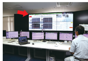
浄水管理センター内の大型ビジョンにACTMoSの監視画面を表示し、随時状態の確認ができるようになっている。また、異常発生時にはモニタ上に警報が表示されて職員の注意喚起を行っている。
