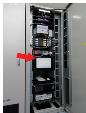
ACTMoS導入以前からデータ管理システムとして運用しているアズビルの総合プラント情報マネジメントシステムePREXION™。他社監視システムが収集したデータを含む、各施設の運転データを一元的に蓄積。監視・運転状況の分析などに利用している。
