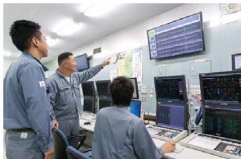
アノン製造プラントの集中監視を行う計器室。APS5000 の監視・制御端末の上方には、65 インチ大型モニターを設置。平常時には APS5000 などの監視画面を表示し、警報発生時には ACTMoS の監視画面が強制表示される。警報が発せられた際には現場のメンバー全員が画面を見て状況を共有し、対処に向けた連携が取れるようになっている。
