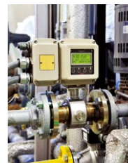
動力プラントの貫流ボイラに設置されているスマート電磁流量計MagneW TM 3000FLEX + 。
