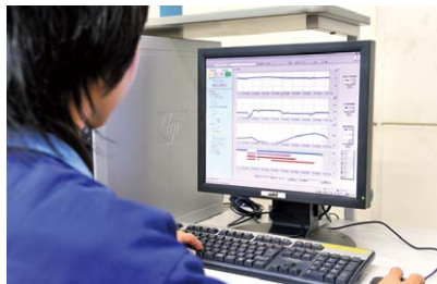
動力室に設置されたU-OPTの監視制御端末。
